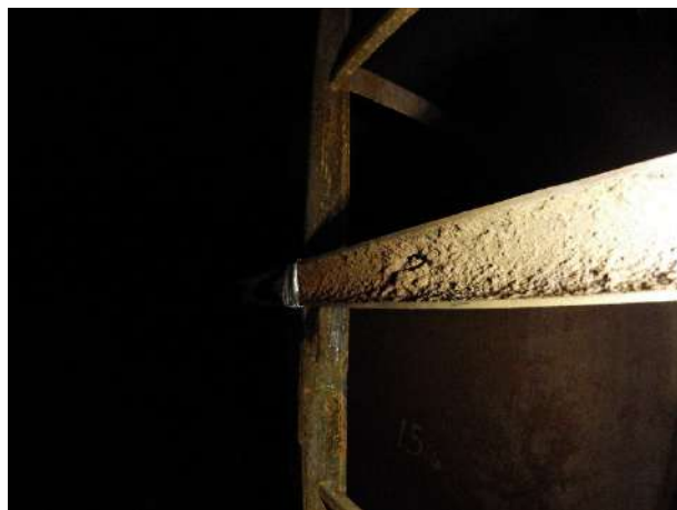
腐食のテストピース
