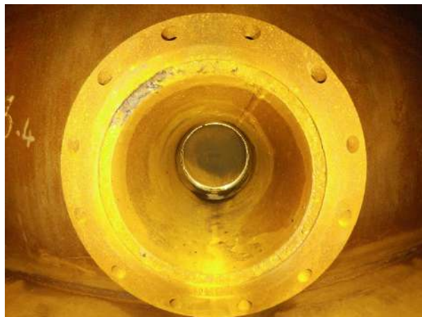
タンク底面のノズル
