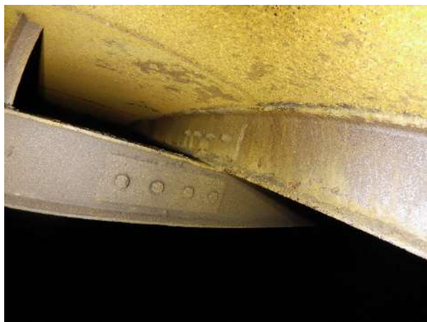
天井のボルト
